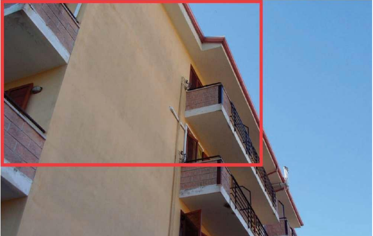
Imm.n.15: - foto esterno, lato est, dell'appartamento al terzo piano dell'edificio condominiale in Telese Terme alla Via degli Aironi n.11 (ex Via Fausto Coppi) ed identificato nel registro del Catasto Fabbricati al Fgl.n.9- p.II.n.1418-sub.17.
